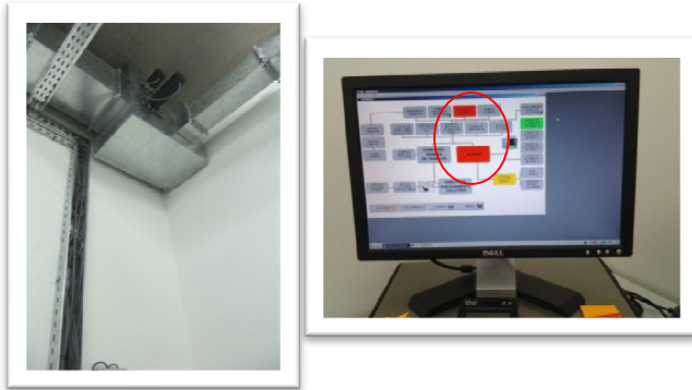
Figura 15– Detector de chimenea y alarma luminosa indicadora de descargas de actividad elevadas al medioambiente.
