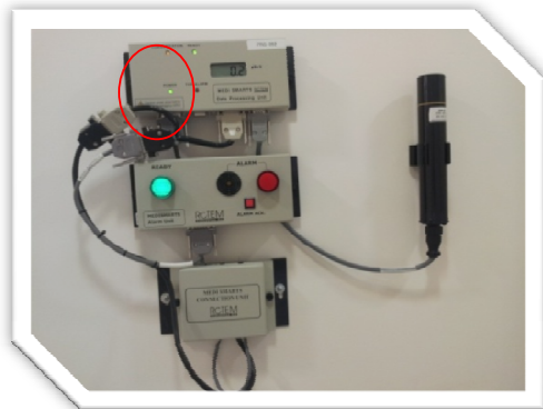
Figura 13 – Detector de área y alarmas asociadas a su funcionamiento.
