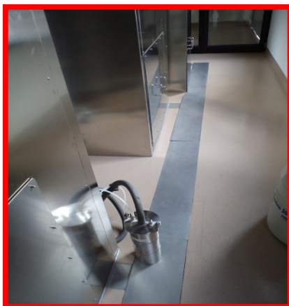
Figura 18– Ilustración de los canales en el piso que contienen las líneas de transferencia.
