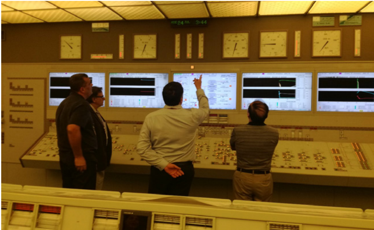
Visita técnica de los expertos del proyecto CLOR a la sala de control de la Central Nucleoeléctrica de Laguna Verde, México Visita técnica de especialistas do projeto CLOR à sala de controle da Usina Nuclear Laguna Verde, México
